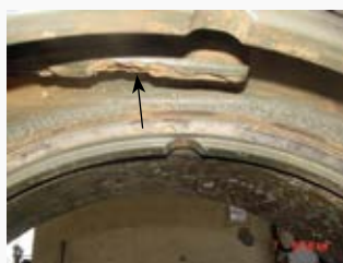
Коррозия/повреждения второй направляющей диска
