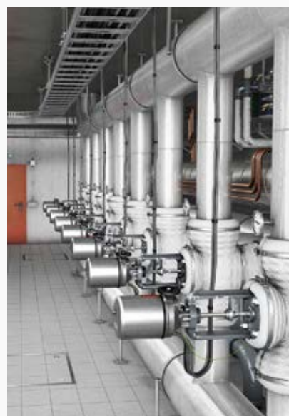
Электроприводы ES на объекте
