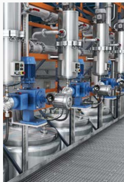
Компактные электроприводы на объекте
