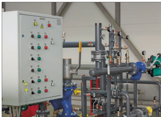
Пример монтажа – индивидуальный тепловой пункт
