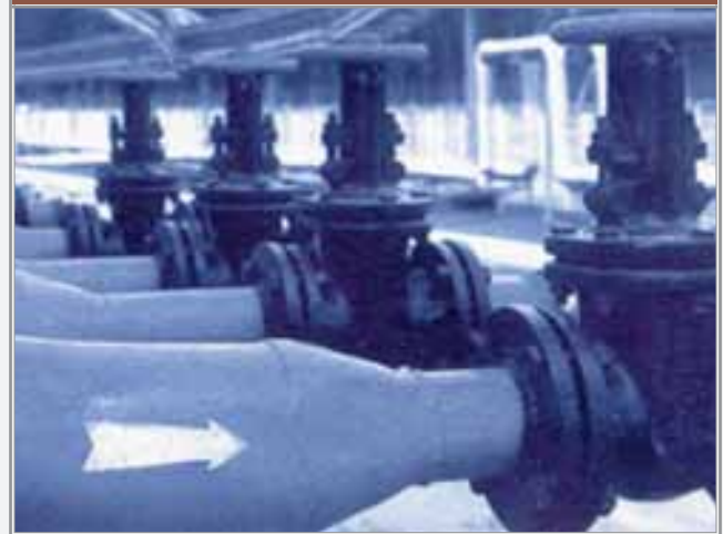
Рис. 5. Сужение трубопроводов газораспределительной станции
