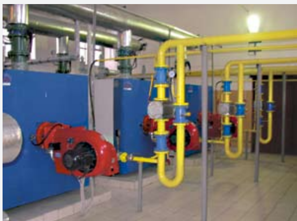
Котельная, смонтированная УЭСК «КОРАЛ» на базе котлов «КОРАЛ УРАН»
