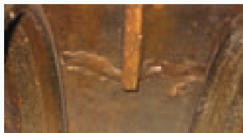
Рис. 7. Трещина «пузовины» корпуса, соединяющая уплотнительные седла
