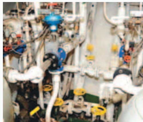
Этот трубный узел с установленной на нем арматурой управляет распределением пресной воды современного грузового морского судна. Каждое крупное океанское судно имеет несколько таких систем управления жидкой средой, что является залогом успешного фрахта
