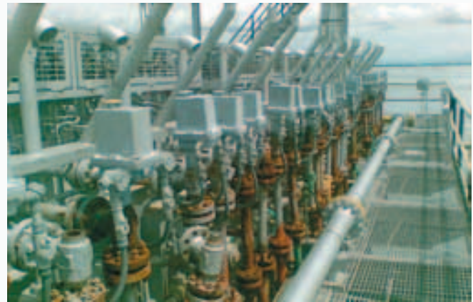
Шеренга электроприводов на нефтепромысловой платформе на озере Маракаибо (Венесуэла)
