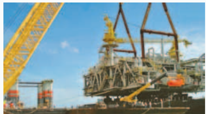
Огромный кран готовится поднять, перенести и установить верхнюю часть платформы Blind Faith на ее корпус. Расположенная на глубине более чем 6500 футов, Blind Faith является одной из самых глубоководных нефтяных платформ в мире. Anadarko имеет 25% прямого долевого участия в проекте, управляемом Chevron (фото Anadarko)
