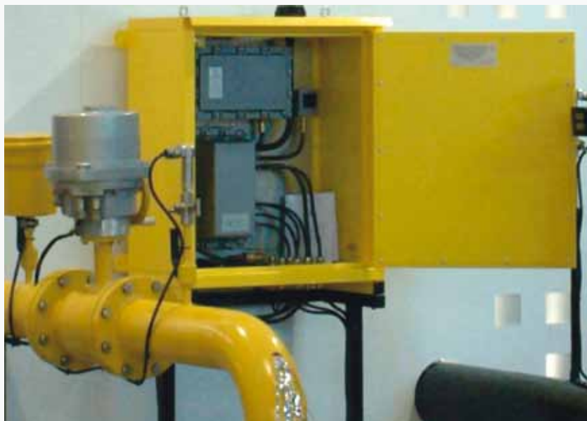
Рис. 1. АСДУК-Э и привод на арматуре
